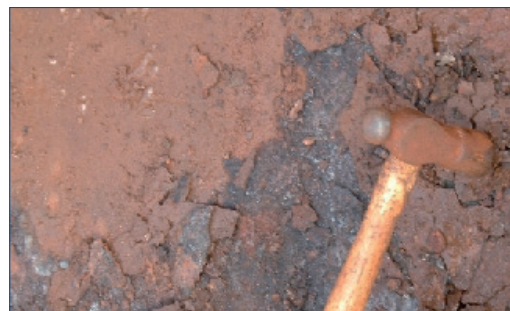
Zoom sur la platform corrodée
