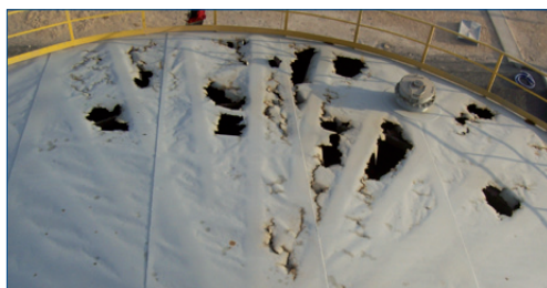
Toit de réservoir troué
