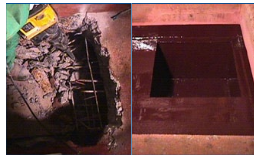
Regard d'acide gravement détérioré réparé
