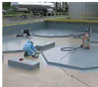
Protection des bacs de rétention
