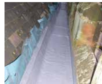
Joints de gouttières
