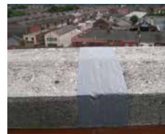
Joints sur les murs de parapet et les pierres de couronnement
